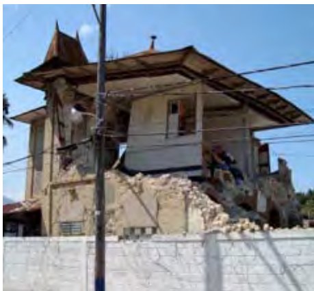
Résidence gingerbread au Bois-Verna, endommagée par le séisme du 12 janvier
